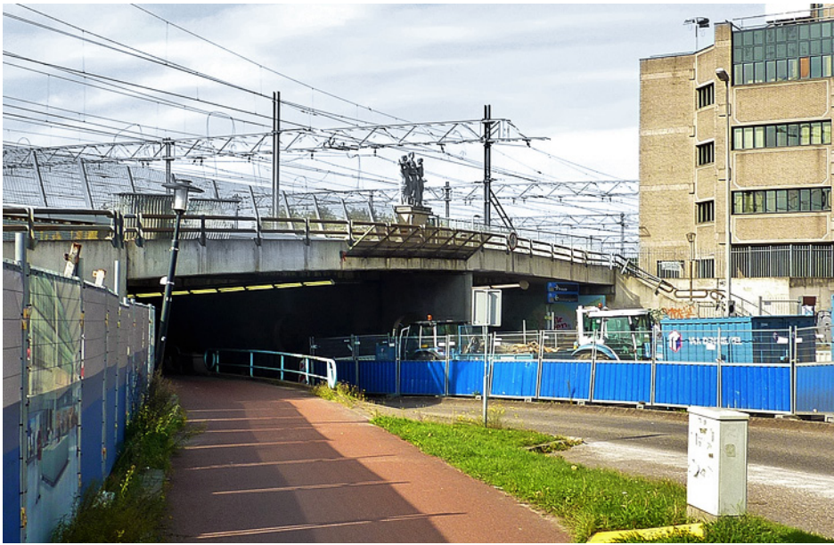
1 De Leidseveertunnel anno 2013: een deplorabel geval
