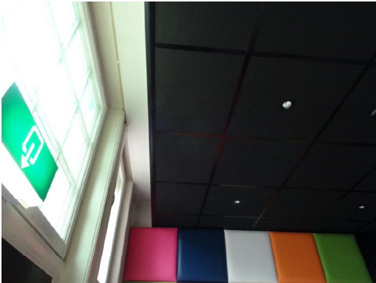
Afb. 5.44 Het systeemplafond in de publieksruimte van het cafetaria. Links het bovenraam van de vroegere hoofdentree. Midden-onder de wandbekleding van de smalle oostelijke wand, met kleurige lederen panelen.
