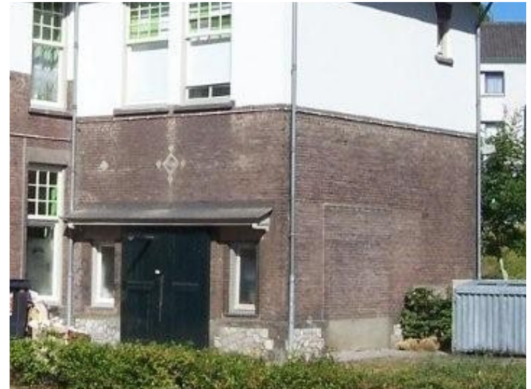
Afb. 5.34 De oostgevel, met de rommelige afwerking van de dichtgemetselde toegang; opvallend is vooral dat de betonnen plint uitsteekt boven de originele natuursteen plint. Detail van foto uit 2010, coll. W. Mensinga.
