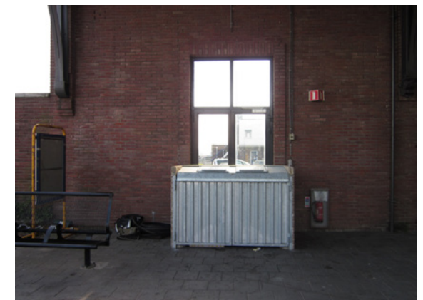
Een deur dichtgezet met een container. Probeer in het gebruik van het gebouw ad-hoc oplossingen die verstorend werken te voorkomen, 2013.
