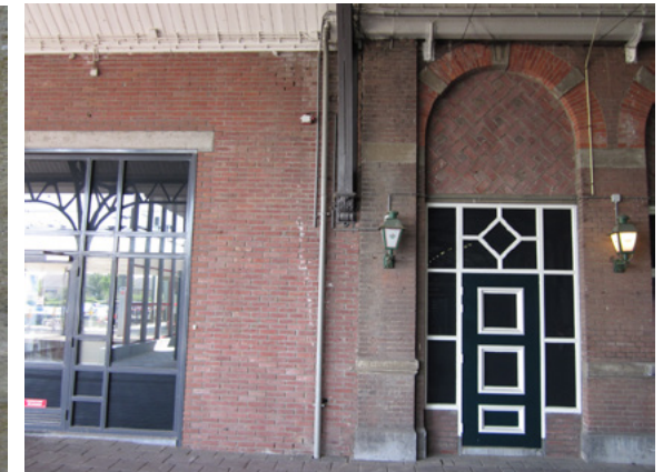
Integratie van een door Van Ravesteyn ontworpen deurkozijn in een muurvlak van het perronplein uit de bouwperiode Schill Haverkamp (rechts). De pui links is recent, 2013
