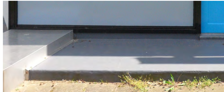
Afb. 4.6 Geschilderde betonnen voet, sextant te Bussum Zuid. Links de met staalplaat beschermde kabelgoot.
